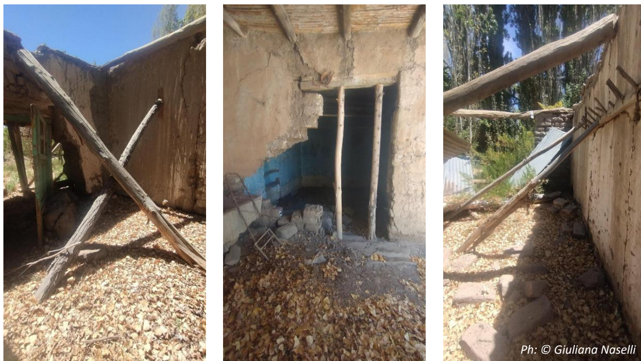
Figura 56: Detalles de sectores del edificio del casco, con derrumbes y apuntalamientos
