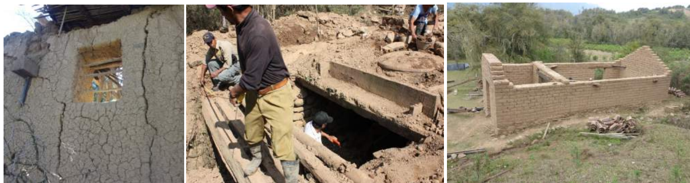
Izquierda: detalle de uno de los muros con grietas y signos de deterioro del techo previo a su restauración; Centro y derecha: Tareas de reconstrucción total del edificio, luego de la devastación sufrida por las lluvias en febrero de 2015 (Fotos: archivo PN Baritú)
